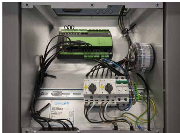
Skrzynka podłączeniowa zasilania elektrycznego oraz sterowania zewnętrznymi funkcjami GOLD o wielkościach 04-40 umieszczona jest na obudowie centrali. Układ sterowania w centralach GOLD o wielkościach 50-120 umieszczony jest wewnątrz środkowej części centrali.
