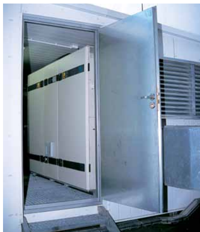
na dachu budynku, w dodatkowej obudowie
