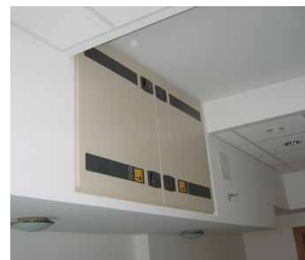
podwieszona pod sufitem, obudowana
