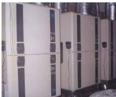
w pomieszczeniu, w pionie
