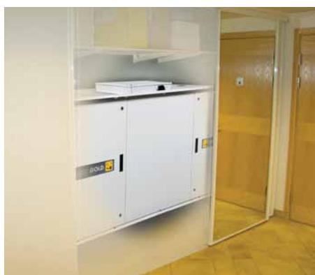
w pomieszczeniu, zabudowana w szafie
