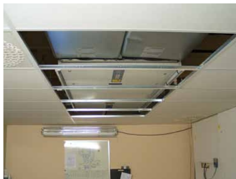
w pomieszczeniu, podwieszana pod sufitem
