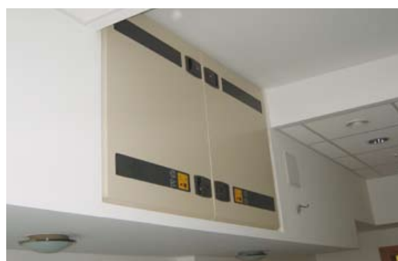
podwieszony pod sufitem
