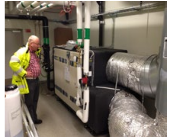
Björn Adler (technicien) inspectant une centrale de traitement d'air GOLD. Photo: Swegon
